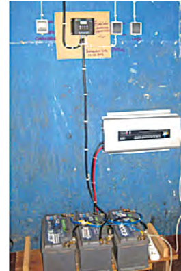
Figure 7. Assemblage d'alimentation solaire de l'hôpital de Bangumi au nord de la province de Bandundu en RDC
